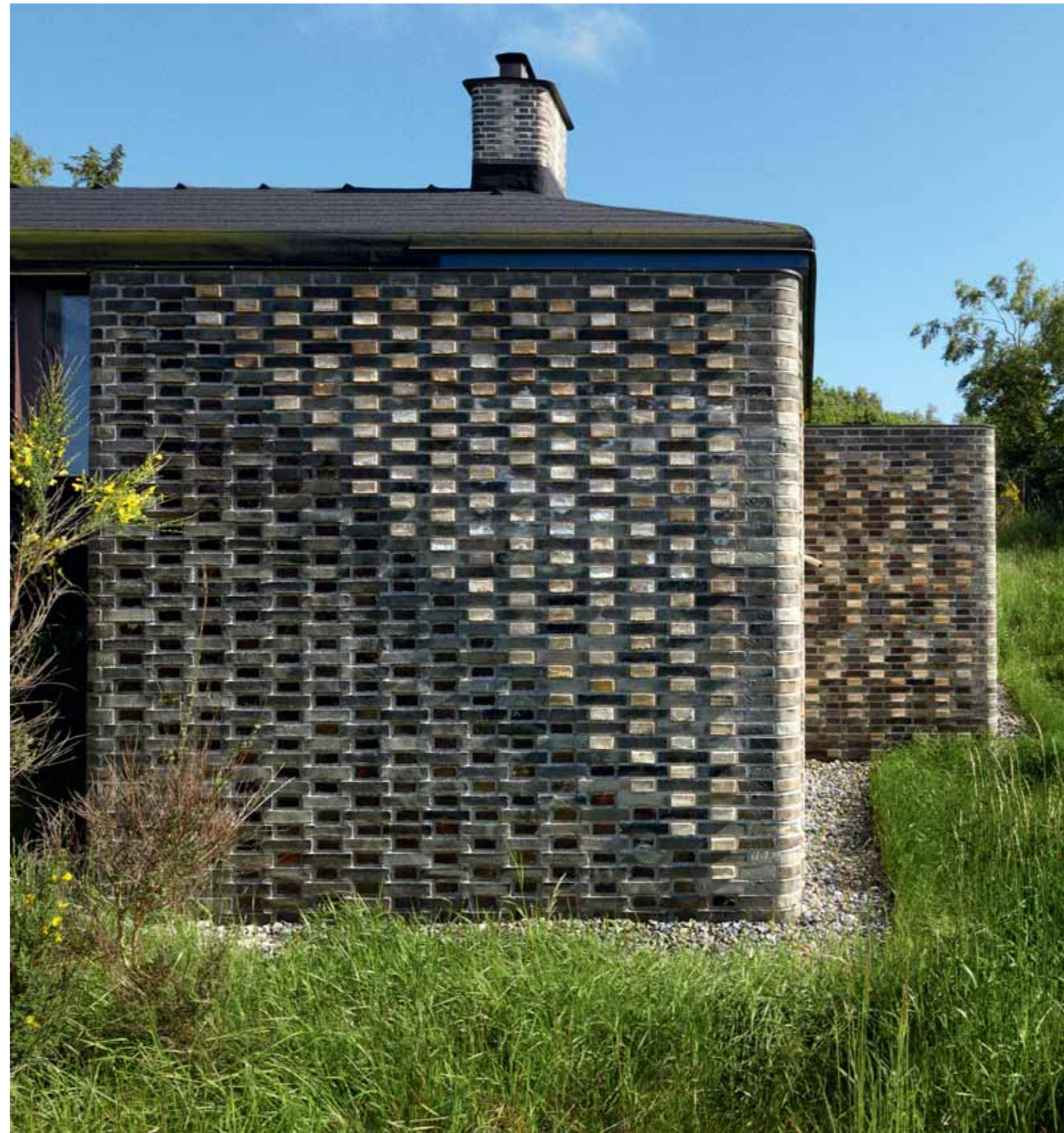
Die Sektionen der Mauer haben jede ihr eigenes Mauermuster – ausgeführt mit Kohlebrandziegeln in drei verschiedenen Farben – D48, D54 und D72.
