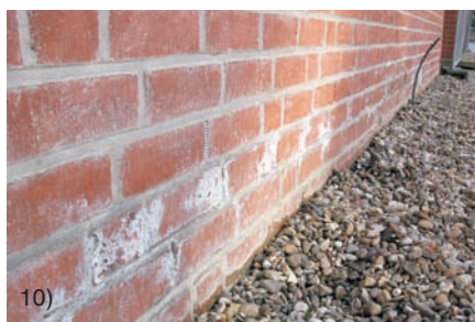
Bilder 9 und 10. Ausblühungen am Mauersockel durch aufsteigende Feuchtigkeit im Verblendmauerwerk, da die angelegte Sickerschicht nicht funktioniert hat
