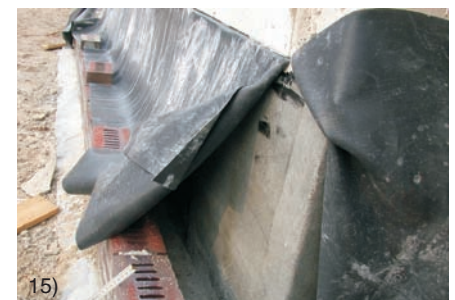
Bilder 14 und 15. Eine zweistufige Abdichtung des Sockels ist nach der neuen DIN 1053-12 nicht mehr erforderlich. Gemäß der Abdichtungsnorm DIN 18195-4 ist die Aufstandsfläche der Verblendschale durch geeignete Abdichtungsmaßnahmen gegen Durchfeuchtungen zu schützen. Die oberen Kunststoffbahnen als sog. Z- oder L-Folien können entfallen
