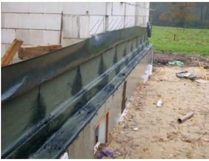
Bild 11. Schweißbahnen werden immer wieder zur Abdichtung des Sockelmauerwerks von zweischaligen Außenwänden verwendet, obwohl sie in DIN 18195-4 für waagerechte Abdichtung in und unter den Wänden nicht geführt werden. Die Drahtanker sind zu hoch angeordnet worden. Um ein Abrutschen der Verblendschale über ihr Auflager zu verhindern, sollen die Drahtanker so tief wie möglich angeordnet werden. Eine Perforierung der Abdichtungsbahnen durch Drahtanker ist daher unvermeidbar und unbedenklich. Die Durchdringungen sollen dennoch nach DIN 18195-9 nachträglich abgedichtet werden
