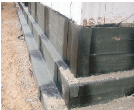
Bild 12. Abgesehen davon, dass hier Schweißbahnen unter die Verblendschale geführt wurden, ist die Abdichtung aus zwei wichtigen Gründen fehlerhaft:
