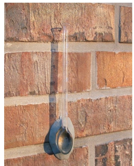
Bild 2. Der Wassereindringprüfer von Karsten ist zur Beurteilung der Schlagregensicherheit von zweischaligem Verblendmauerwerk nicht geeignet
